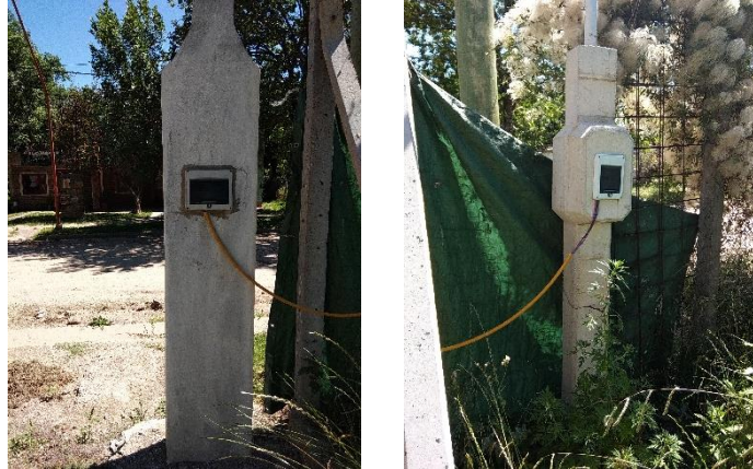
Toma/Tablero General / Acometidas
