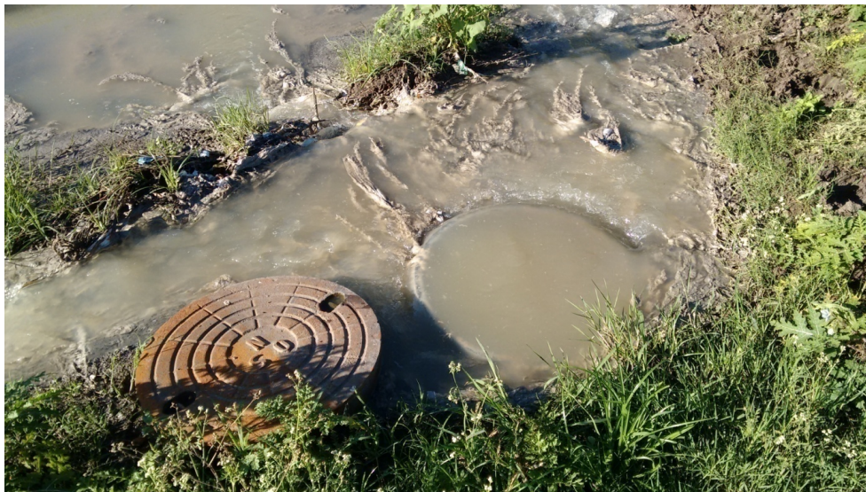
Imagen 7. Cámara desbordada, lindante al predio de Lagunas de Tratamiento.
